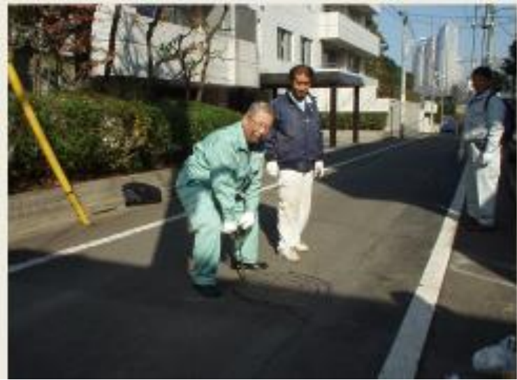
埋設されている下水管を調査するためマンホールを開ける (H14年12月64歳)
